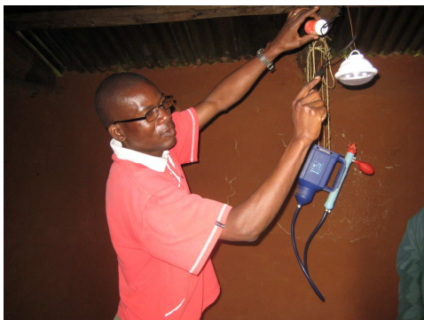
Patrick bei Inneninstallation von Lampe und Ersatzbatterie
